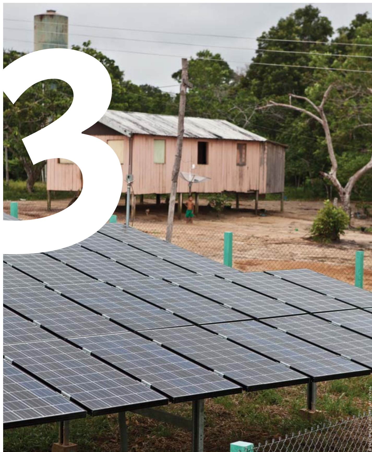
imagem MINIUSINA FOTOVOLTAICA EM BOM JESUS DO PUDUARÍ, AMAZONAS.
