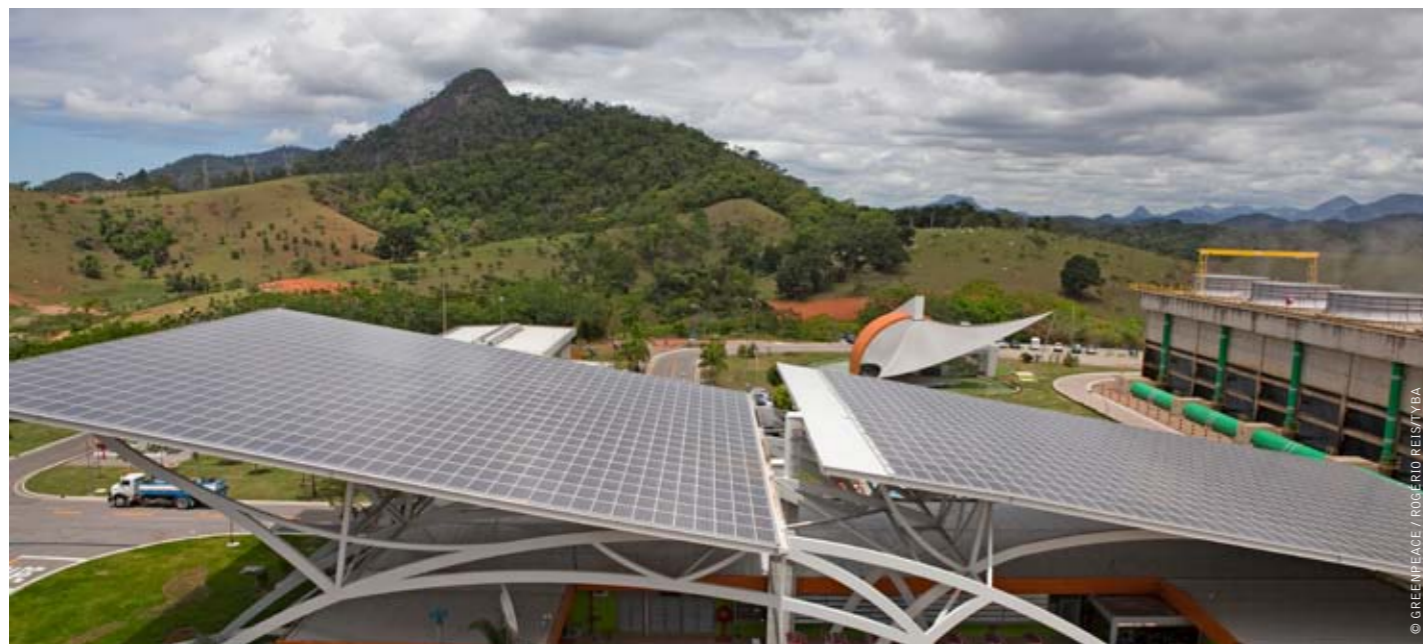
imagem USINA FOTOVOLTAICA NA UTE NORTE FLUMINENSE.
